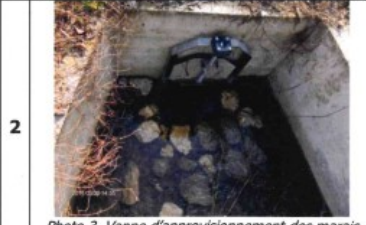
Photo 3. Vanne d'approvisionnement des marais de Montfort
